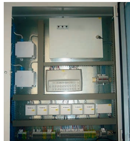
▲ Оборудование в боксе
