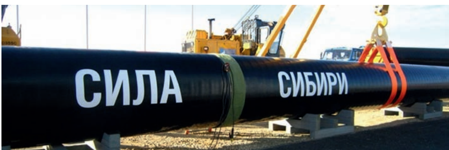
▲ Газопровод "Сила Сибири"
