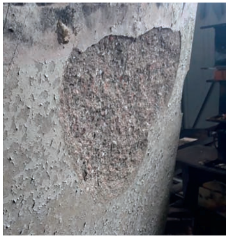
▲ Рис. 5. Результат взрывообразного разрушения бетона
