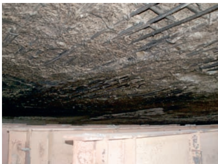
▲ Рис. 1. Около 1200 м 2 бетона было повреждено во время пожара при строительстве моста через бухту Золотой Рог
